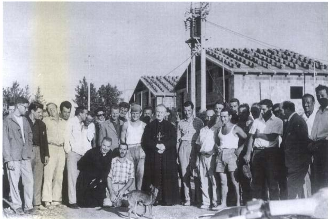
La visita di Mons. Giacinto Tredici ad uno dei primi cantieri della Cooperativa "La Famiglia" in città.
