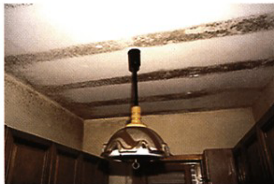
Foto 2 – Condensa superficiale con termoforesi in corrispondenza dei travetti del solaio
