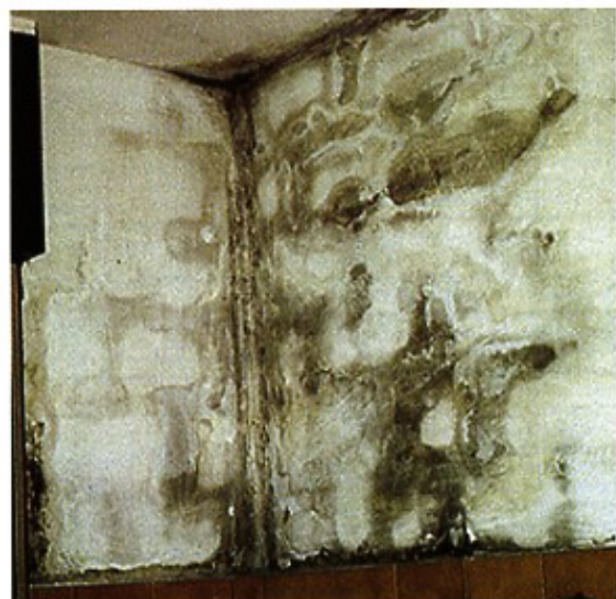
Foto 3 - Pareti completamente intaccate dall'umidità accentuata dalla probabile presenza di acqua interstiziale nelle murature
