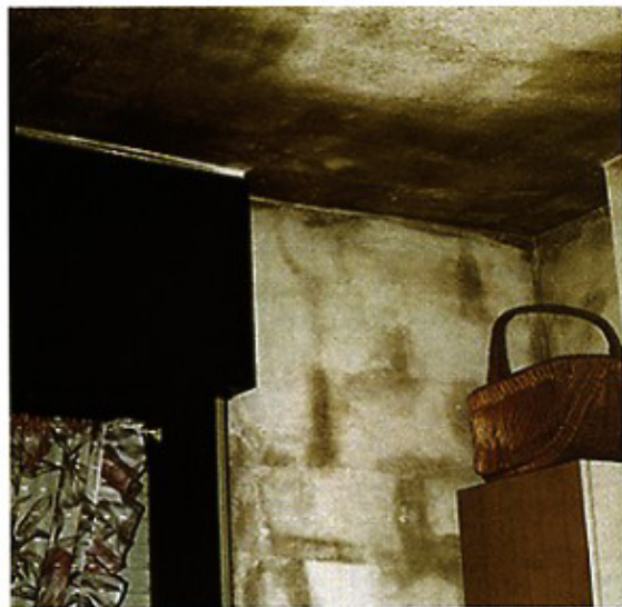
Foto 4 - Ambiente interessato da umidità e condensa su tutte le superfici
